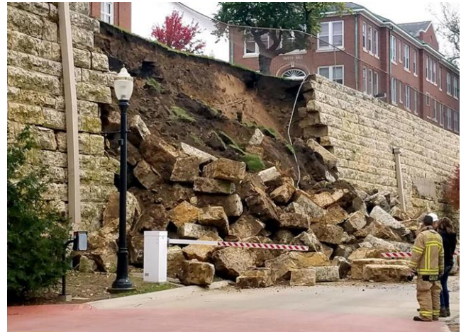
14-Sep-2017 (chinadaily.com.cn) Dinding penahan runtuh di sebuah kampus di Iowa. Tidak ada korban, aktifitas terhenti. / Collapsed retaining wall in a campus in Iowa. No injury. Activities stopped.
